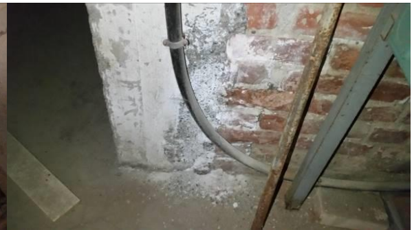
Kalkkihärmää maanvastaisessa seinässä
