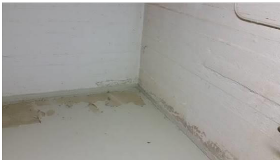
Maalipinta hilseilyt väestönsuojan reuna-alueilta
