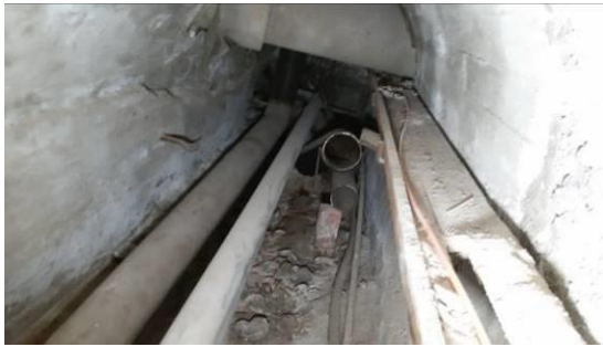
Kellarista lähtevä putkitunneli, rakennusjätettä tunnelissa
