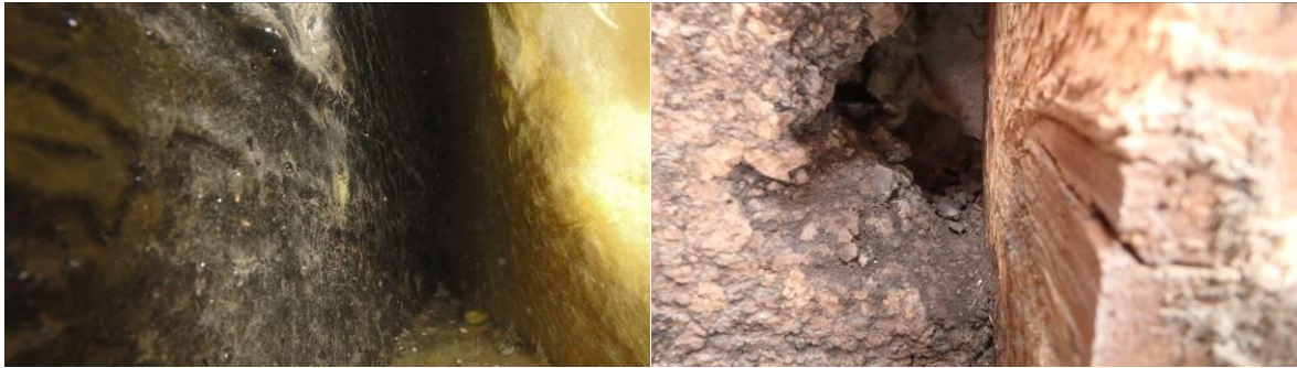
Sokkelin villa oli osittain kiinni betonissa ja osittain irtoi. Sokkelin peltiverhouksen takana korkkia, jonka takana villaa.
