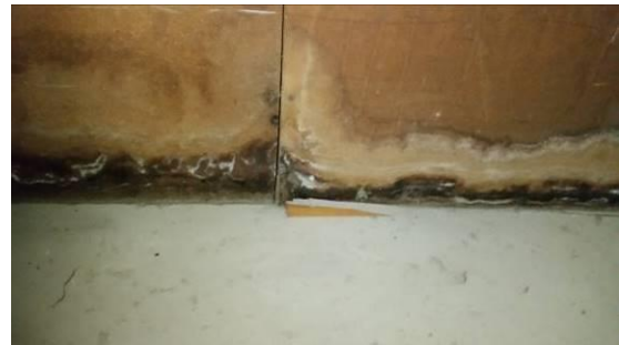
Kevyt väliseinä lahonnut alaosasta
