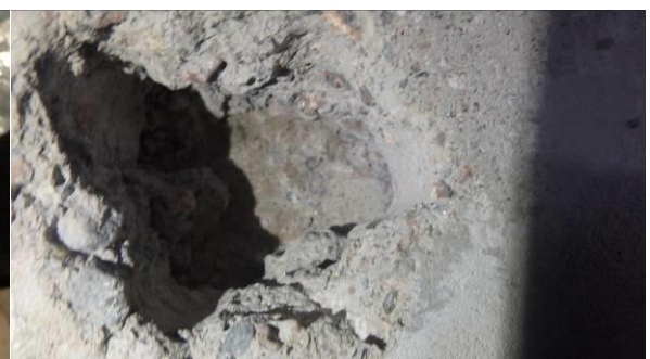
Laajennusosan pintalaatan alla ei havaittu täyttöä
