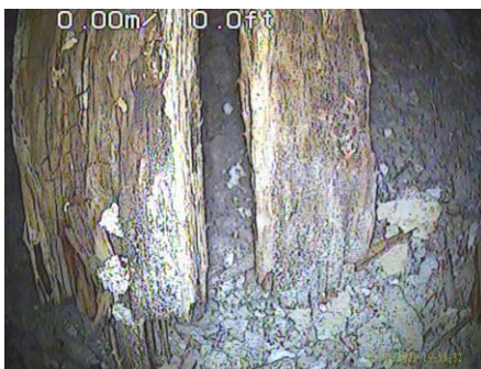
Lahonnutta muottilaudoitusta kaksoislaattapalkistossa
