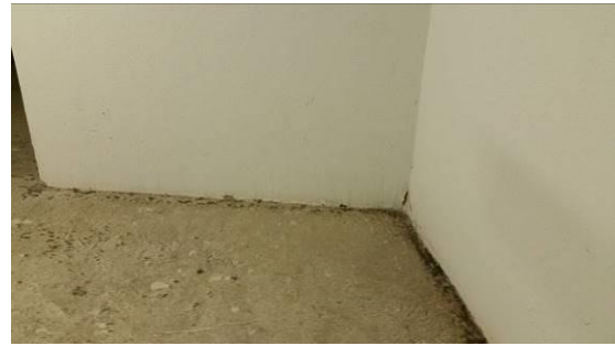
Epäpuhtauksia lattialla (VSS), tilasta lähtee ilmahormeja
