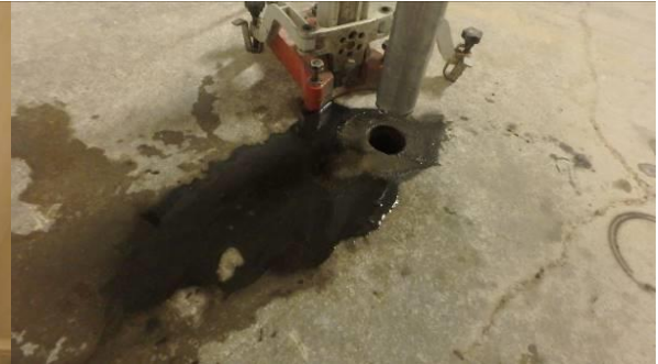
Rakenneavauksessa, VP2, neste mustaa ja öljyn hajuista
